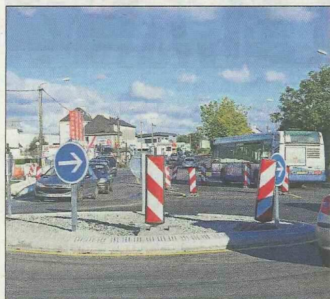
Le giratoire desservant la tranche 1 de Cœur de Poulfanc (le mail et les îlots 1 et 2) est presque achevé. Il ne reste plus qu'à couler l'enrobé...
